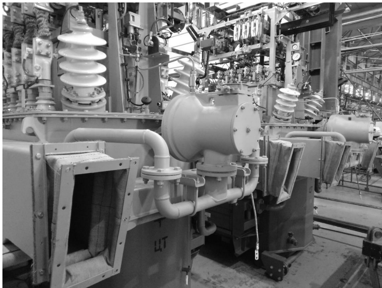
Рис. 2. Блок тягового трансформатора локомотива серии 2ЭС5К «Ермак» в сборе с маслонасосом
