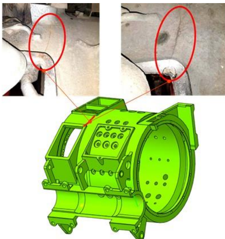
Рис. 1. Типовая трещина в двигателе НБ-514, возникающая в межреберном пространстве
