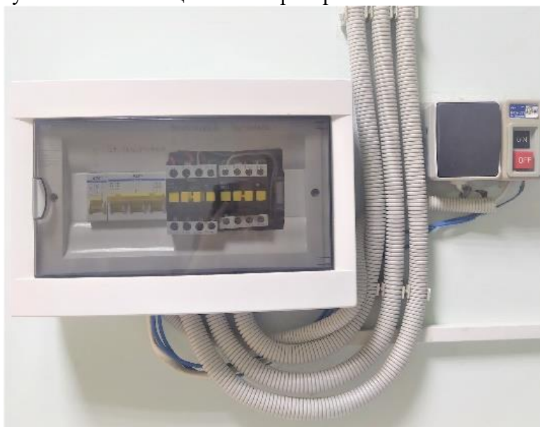
Рис. 1. Щиток управления системой приточно-вытяжной вентиляции в лаборатории
